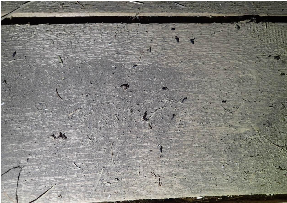
Abb. 3: Fledermauskot im Dachboden des Südflügels
