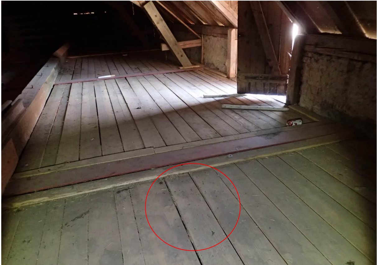
Abb. 2: Dachboden des Südflügels, Stelle mit Fledermauskot rot markiert
